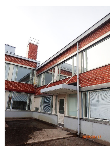
Kuva 9. Keittiön kohdalla ulkoseinää pitkin valuu vesi. Rännikourusta vuotoa.
