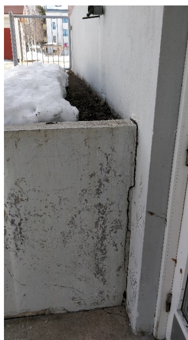
Kuva 12. Sokkelirakenne kiinni multaisessa, jatkuvasti kosteassa maassa. Kohdalle imeytetään sulamisvesiä.
