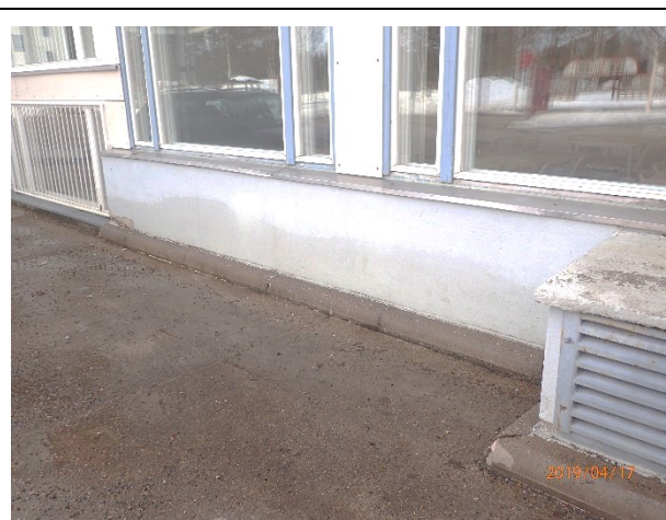
Kuva 10. Ruokalan kohdalla sokkelin pinnassa kosteutta.
