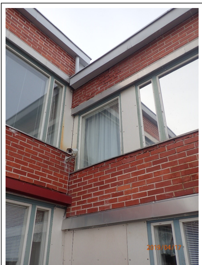
Kuva 13. Keittiön kohdalla vesi valuu ulkoseinää pitkin. Mahdollisia vaurioita ulkoseinän eristemateriaaliin.
